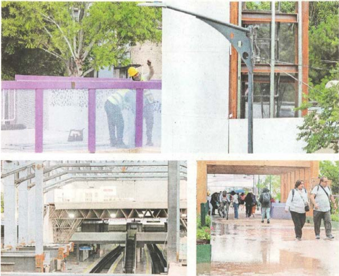
Las labores para concluir los accesos al Jardín Elevado continuaron. En tanto, se ven encharcamientos en algunas zonas de la obra.
