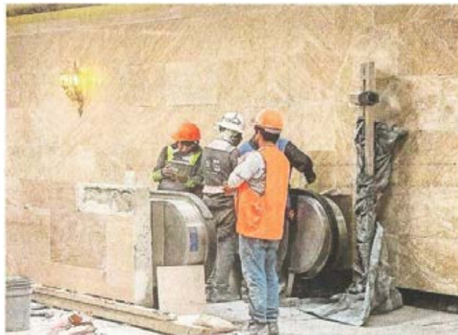
En las estaciones Hidalgo y Bellas Artes seguían acabando con detalles para concluir los trabajos de remodelación.
